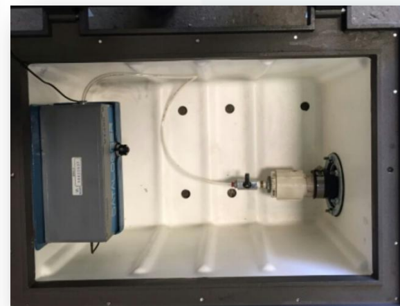
SSC – Módulo 3: Sensoriamento de pressão.
